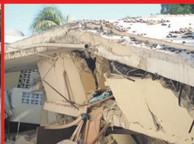
“Mamosa” door de aardbeving ingestort.
